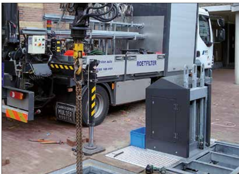
Installation de compacteur enterré sur une place à Helmond (NL).
